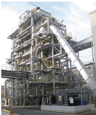
バイオマス発電所
