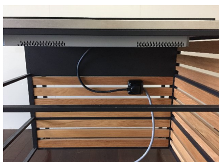
IH用コンセントの設置例 露出型 (250V 30A) (スリット板に取付)
