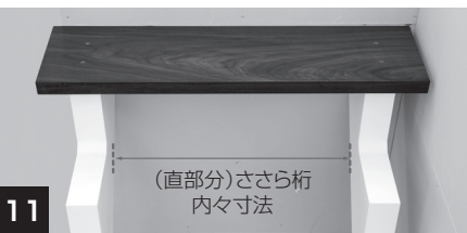
11 踏板を仮置きして、直部分ささら桁の内々寸法が正しく取れているか確認します。
