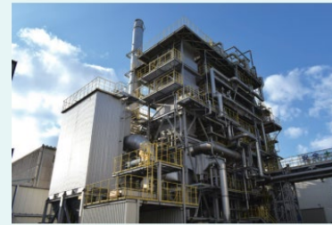
ウッドワン バイオマス発電所
