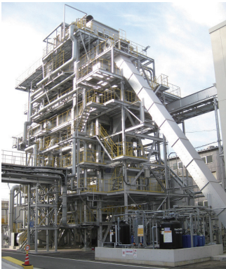
バイオマス発電所
