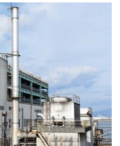
ボイラー(本社)
