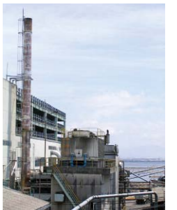
ボイラー(本社)
