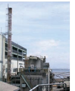
ボイラー(本社)
