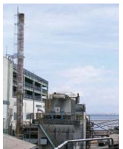
ボイラー(本社)
