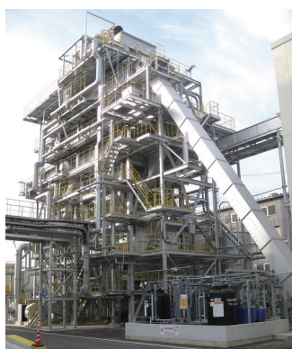
バイオマス発電所
