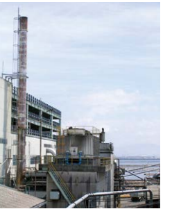
ボイラー(本社)
