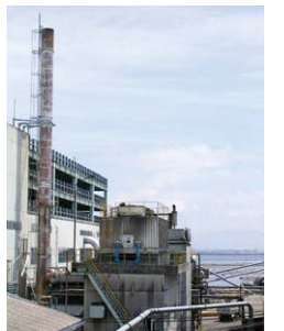
ボイラー(本社)
