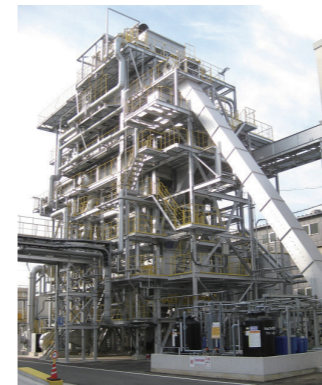
バイオマス発電所
